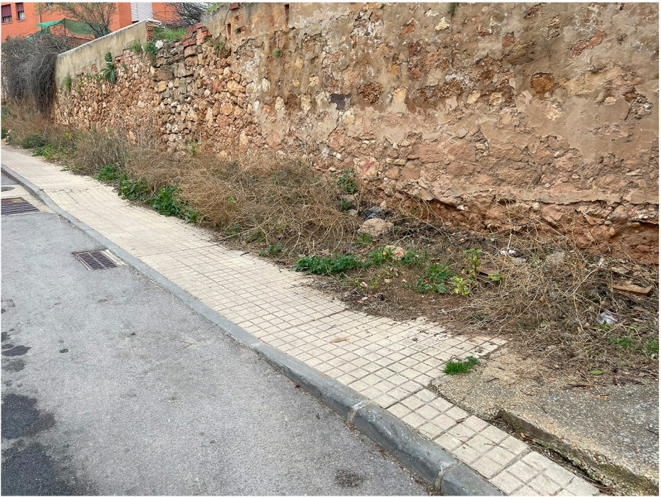
Estado actual de la acera del lindero frontal, qe presenta irregularidades, zona sin pavimentar y salientes que llevan a mínimos el espacio de acera.
